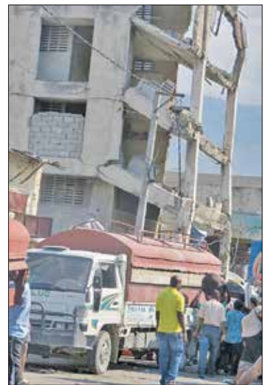
Plusieurs immeubles commerciaux et résidentiels de la capitale haïtienne, plus précisément dans le centre ville, restent toujours idem après 39 mois du passage du séisme
