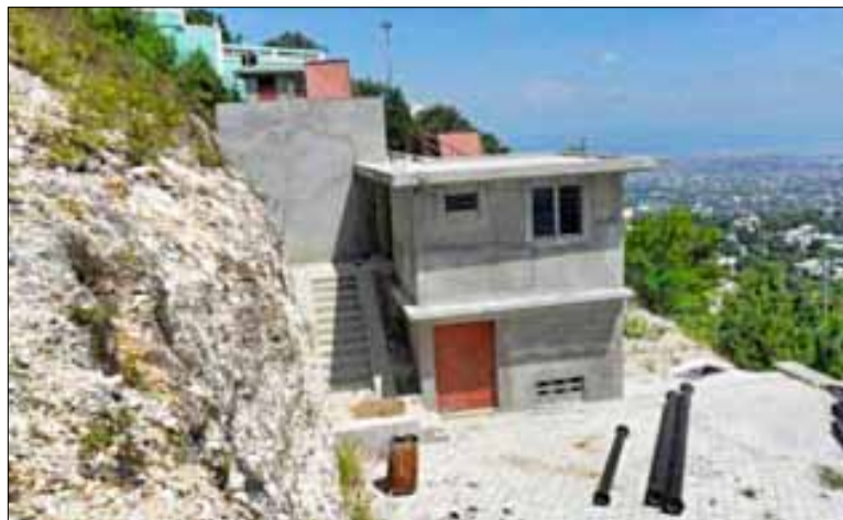
Le nouveau réservoir de Debussy. (Photo - WASH Cluster)
